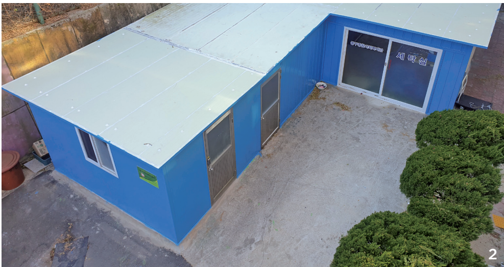
1 태풍 피해를 입어 파손된 푸드뱅크 창고 2 지붕 누수 공사까지 마쳐 한층 안전한 환경이 됐다.
